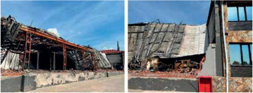
Şekil 7. Deprem sonrası çıkan bir yangında büyük bir hasar yaşanan endüstriyel tesis binası
