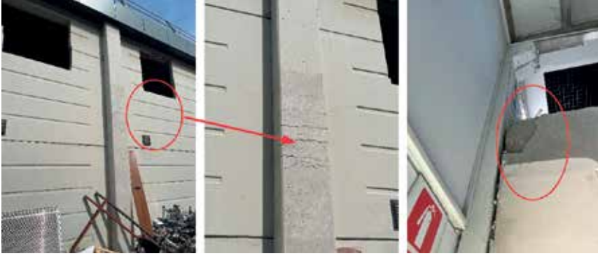
Şekil 5. Tek katlı prefabrik betonarme dış cephe kolonunda "Kısa Kolon" kusuru nedeniyle hasar yaşanması (60 x 60 cm'lik kesite sahip)
